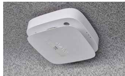
Ein zentrales Schwerpunktthema war 2025 die Erhöhung der eigenen betrieblichen Sicherheit: Brandmeldeanlagen wurden in sämtlichen Fahrzeugen installiert.
