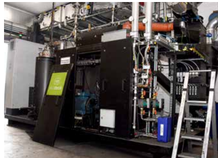
Das Blockheizkraftwerk im Wolfsberger Wirtschaftshof produziert gleichzeitig Wärme und elektrischen Strom – also beides in einem Gerät.
