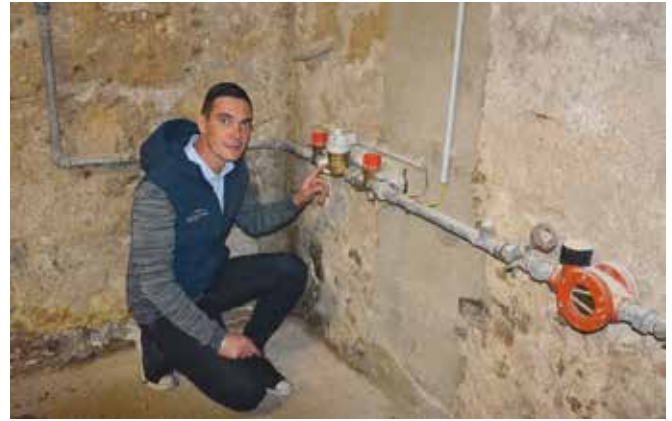
Markus Godez mit dem Lora-Wasserzähler im Keller der Alten Post.
