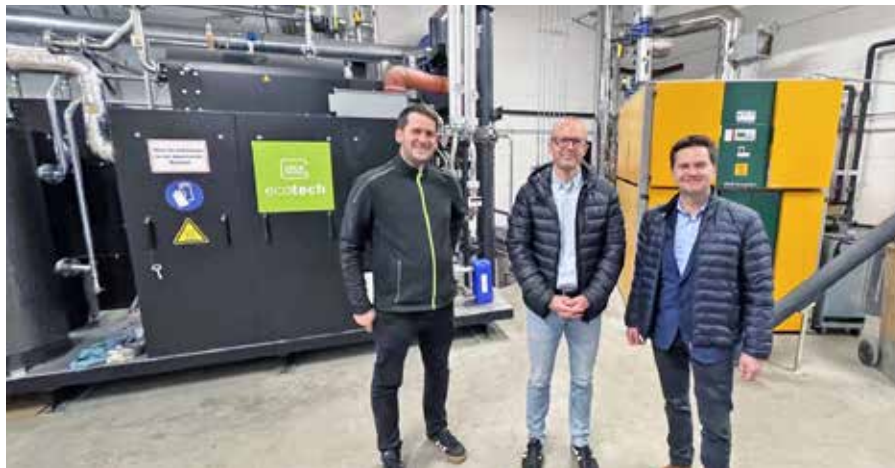
Stadtrat Jürgen Jöbstl, Günther Rampitsch (Leiter Umweltabteilung) und Andreas Leopold (Bauhof) in der Energiezentrale mit dem Biomassekessel rechts und dem Blockheizkraftwerk links.
