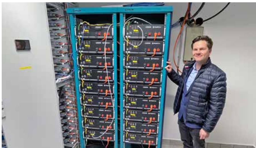
Bild Oben: Der Stromspeicher hat eine Kapazität von 86 kWh.
