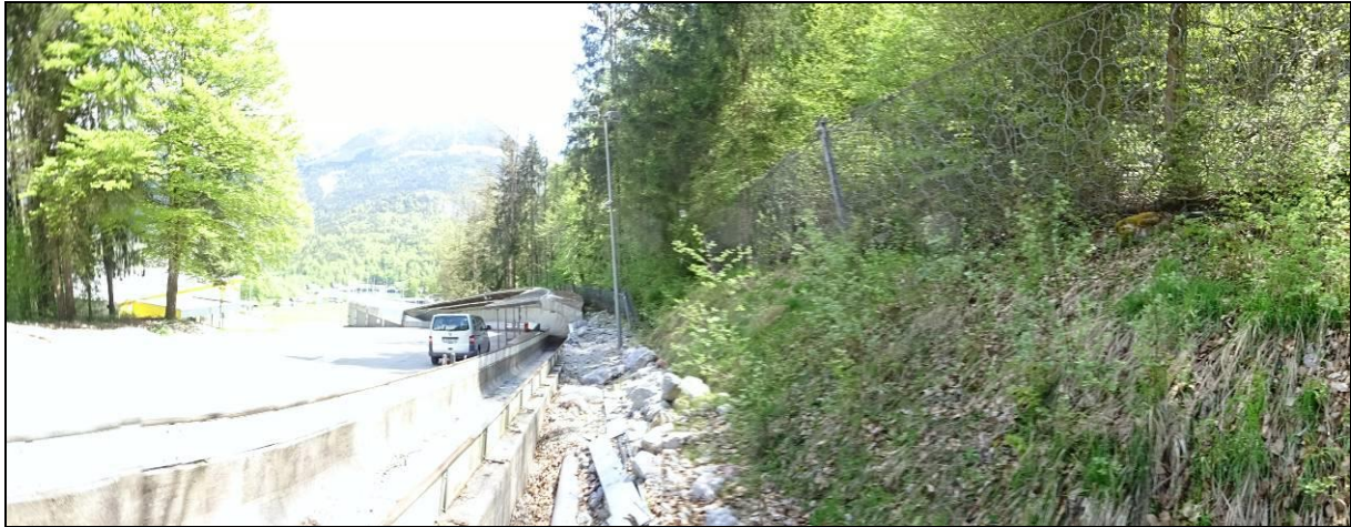
Abbildung 12: Waldsaum am Jodelgefährt mit Steinschlagnetz oberhalb Kurve 7 (Mai 2023, Blick nach Osten)
