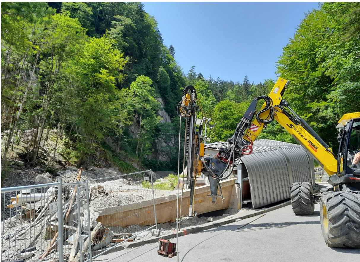
Abb. (20): TB 24 ; nördliche Talseite, bei zerstörtem Bereich Rodelbahn (21.06.2023)
