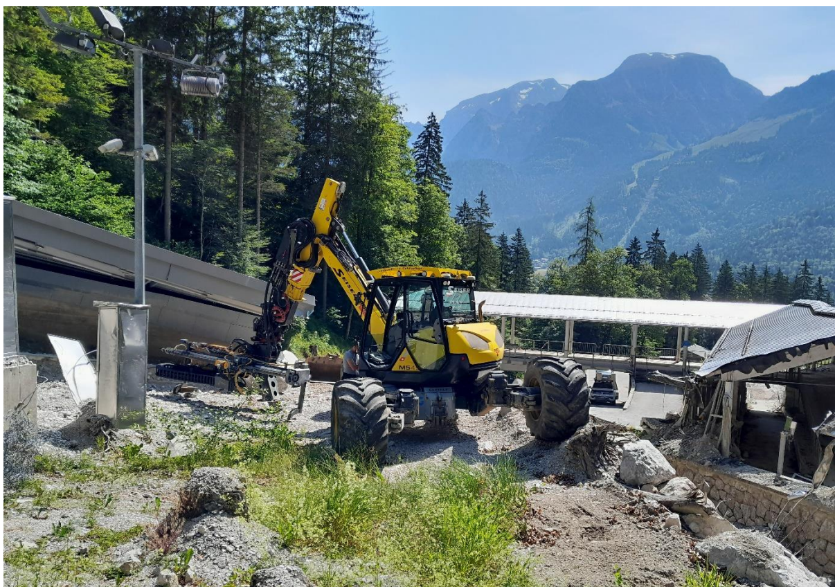
Abb. (1): TB 1 ; zwischen zerstörter Rodelbahn und Klingerbach (20.06.2023)
