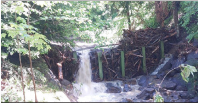
Nießnitzbach hm 20,98; verfüllter Wildholzrechen, Räumung
