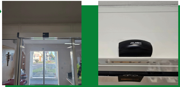
Tausch von defekten Sensoren
