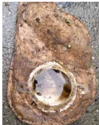
Dutzende Staubsaugerbeutel haben die Pumpstation Koglhof lahmgelegt.
