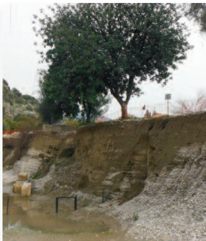
Foto 9: Mauerriss nach Setzung, Quelle: BPS
