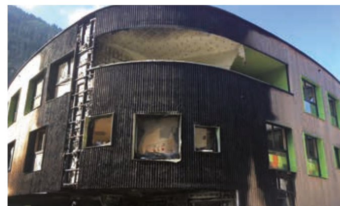
Die Fassade der VS nach dem Brand
