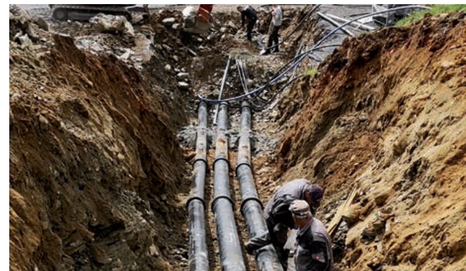
Beschneiungsanlage Richtung Piste 9
