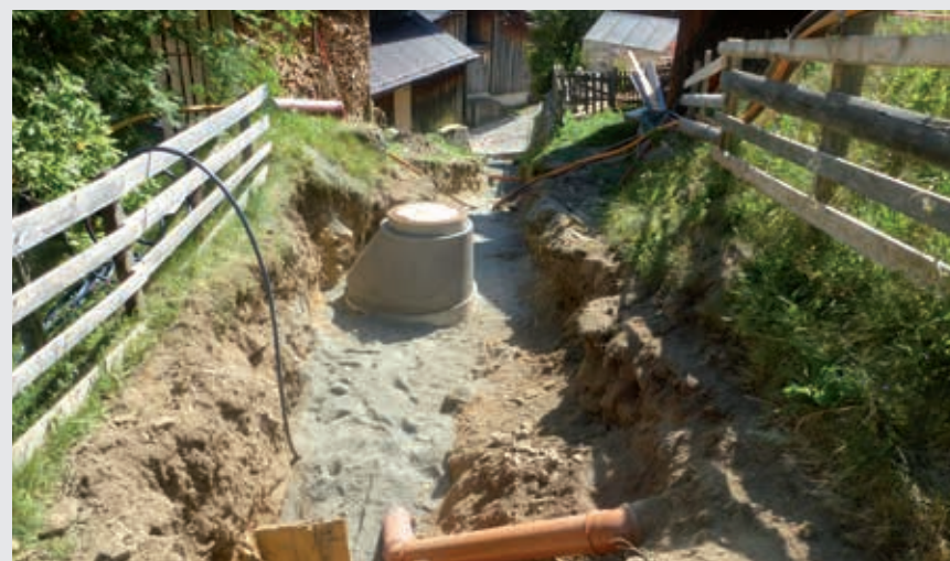
Entwässerungsleitung Klasen-Perpat-Gasse im Weiler Perpat
