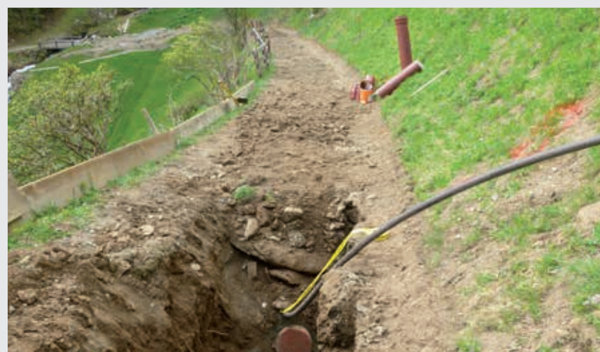
Entwässerungsleitung Klasen-Perpat-Gasse in der "Höll"
