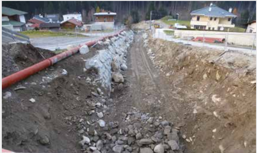
Wildbach- und Lawinverbauung am Schaller
