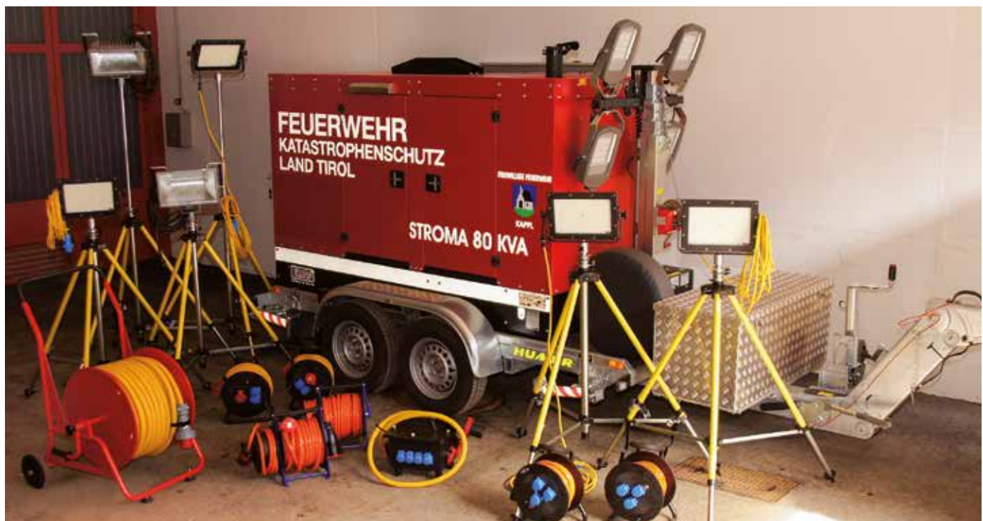
Notstromaggregat der Feuerwehr
