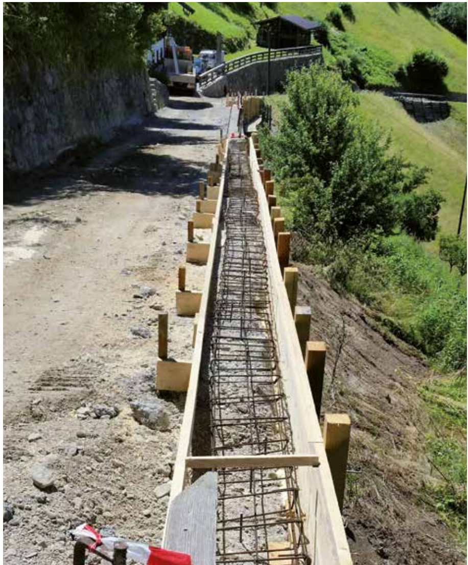
Kanalleitung am Frödeneggerberg
