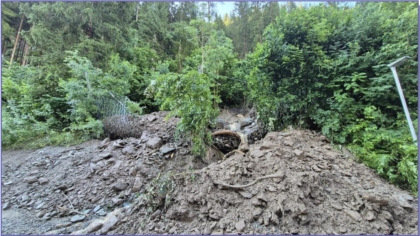
Zerstörte Steinschlagnetze Kirchwald (Bild: M. Zangerl)
