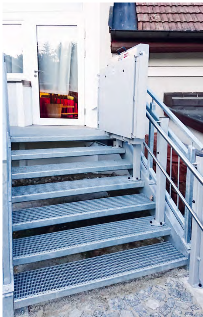
Der Treppenlift auf der neu errichteten Außenstiege
