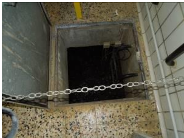
TB Rohwasser Stoßmühle
