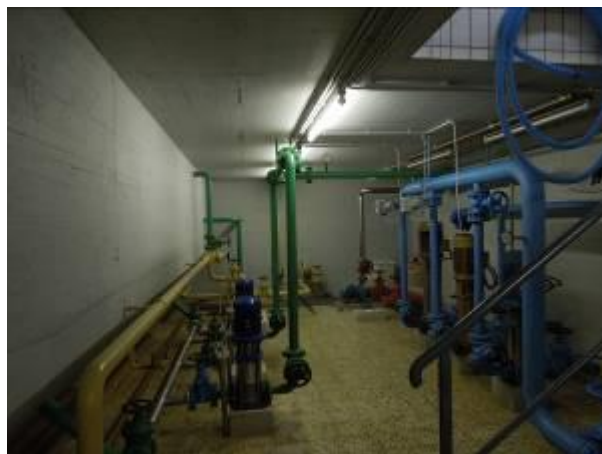
Aufbereitung Stoßmühle Rohrkeller
