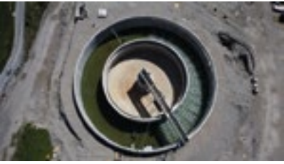
Kombibecken kurz vor der Inbetriebnahme (Bild: Feuerwehr Niederaudorf)
