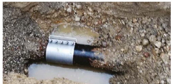
Beispiele von Rohrbrüchen an der Kufsteiner Straße
