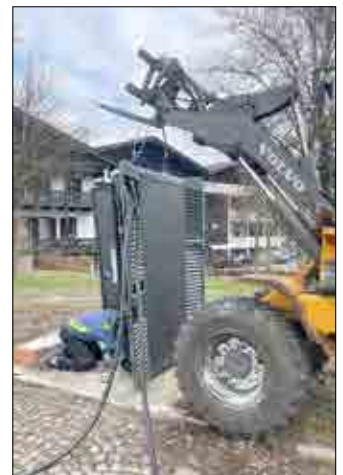
Aufbau der Ladesäule Oberfeldweg an der Gemeinde
