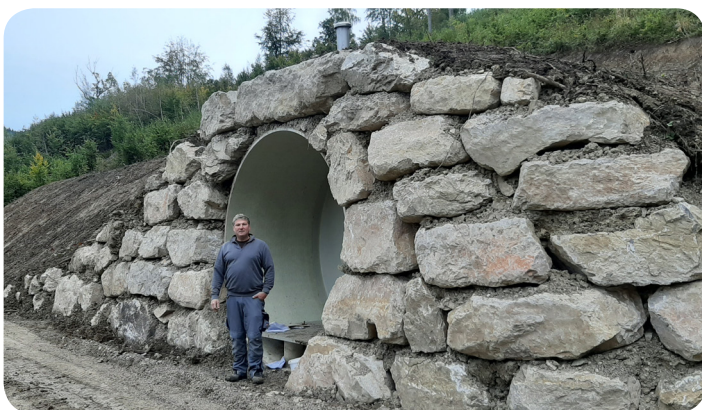
250 m 3 Trinkwasser zusätzliche Speicherkapazität sichert eine störungsfreie Wasserversorgung.
