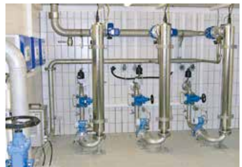
UV-Anlage Tiefbehälter Pretul(Entkeimung)
