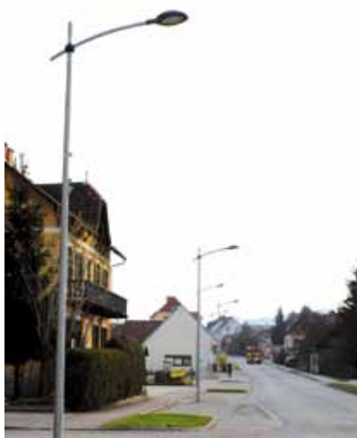
Die neue Straßenbeleuchtung entlang der sanierten Ortsdurchfahrt
