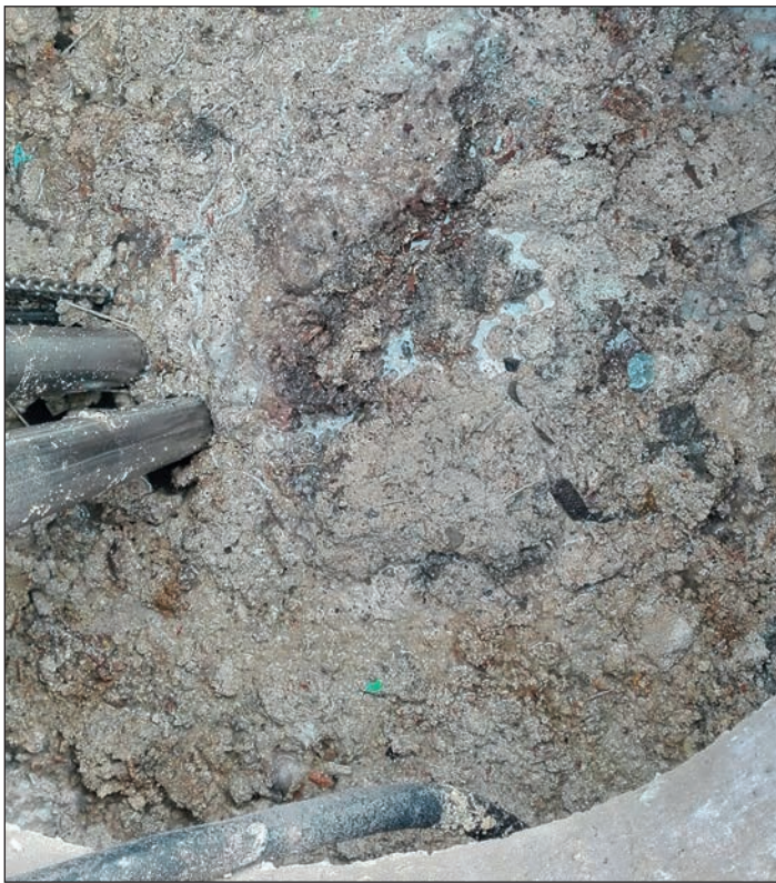
Verstopfung bei der Pumpstation Jahrbach
