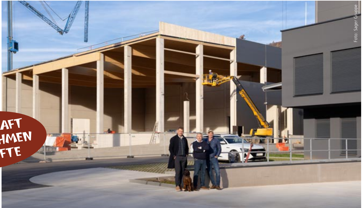
Zwei neue Hallen mit insgesamt rund 15.500 m 2 Nutzfläche machen das Logistikzentrum der Sager-Gruppe zu einem der modernsten Logistikstandorte der Steiermark.
