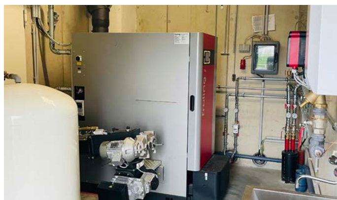
Modernste Heizungstechnik kam zum Einsatz.
