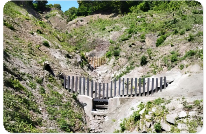
Abbildung 4: Derzeitige provisorische Geschlebesperre
