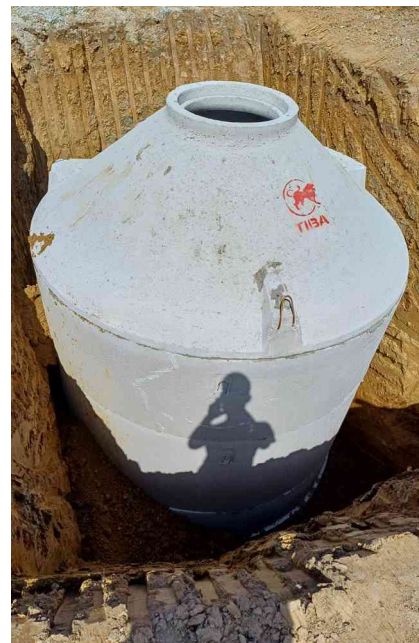
Die Errichtung einer Regenwasserzisterne wird vom Land gefördert
