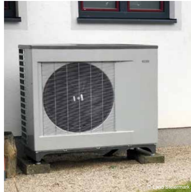
Abbildung: Wärmepumpe im Freibereich
