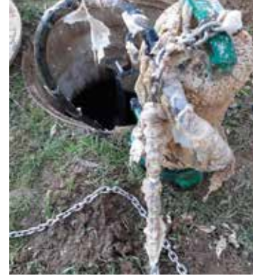
Bi.li. Sammelstelle in Kranach Bi.re. durch Öl, Feuchttücher u.v.m. verschmutztes Pumpwerk der Kläranlage in Langegg
