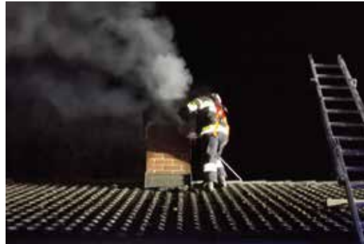
Innen heiß, außen brandgefährlich: Löscharbeiten bei Kaminbrand
