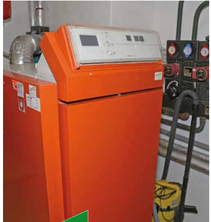
Prüfpflicht: Zentralheizungsanlagen müssen periodisch durch befugte Fachleute überprüft werden.
