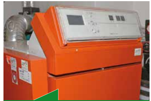
Zentralheizungsanlagen müssen periodisch überprüft werden.
