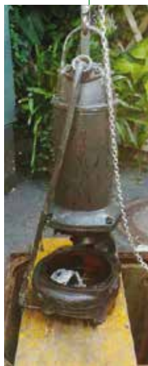
Die Entsorgung von Tüchern und Textilien führt zur Verstopfung der Hebeanlage und sorgt für Pannen und hohe Kosten.
