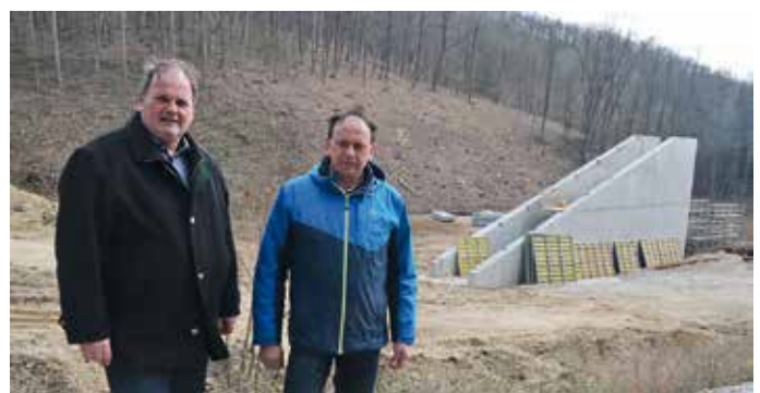
Am 4. April 2023 waren Stadtrat Manfred Daniel und Mödrings Ortsvorsteher Robert Lochner bei einem Lokalaugenschein auf der Baustelle.
