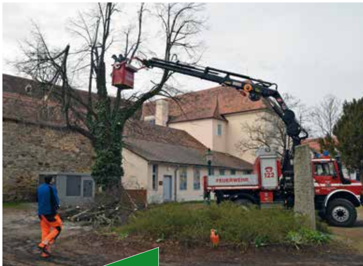
Die Linde an der Stadtmauer musste gefällt werden. Sie stellte bereits eine Gefahr dar.
