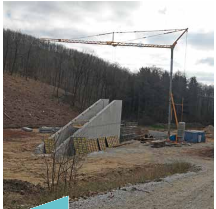
Der Damm wird links und rechts des Einlaufbauwerkes gewaltig: Am Fuß wird er eine Breite von 30 Metern haben, am Scheitel 10 Meter.
