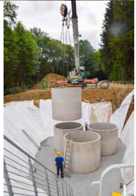
Drei Behandlungsschächte werden Doberndorf versorgen.
