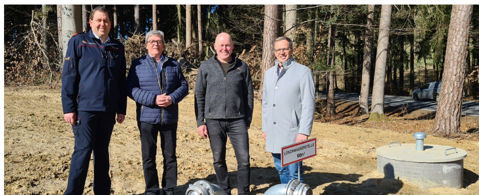
Beim neuen Löschwasserbehälter: von links: Kommandant Christoph Prückl, Bürgermeister Josef Lindner (Gutau), Grundeigentümer Max Leonhardsberger, Bürgermeister Fritz Robeischl
