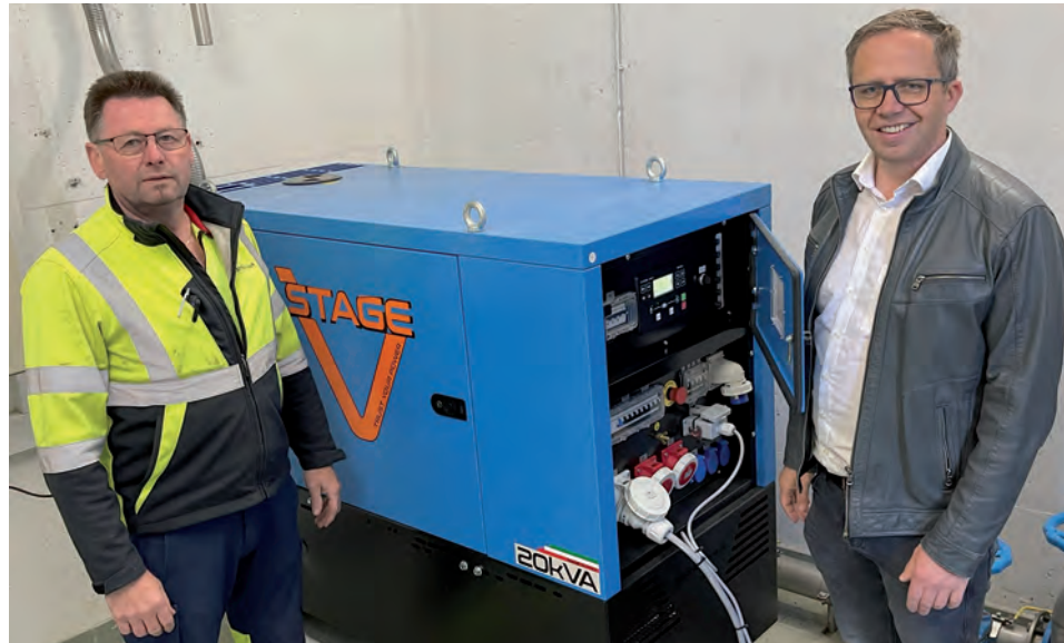
Bauhofleiter Stefan Keferböck und Bürgermeister Fritz Robeischl bei der Inbetriebnahme
