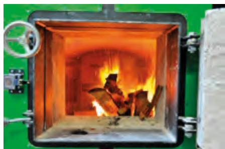
Durch die Verbrennung von Biomasse (Hackschnitzel, Sägespäne, Rinde ...) in den Heizkesseln des Heizwerks wird Wasser erhitzt.
