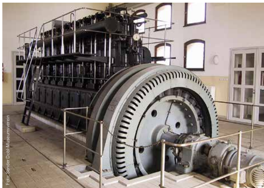
Der mächtige Notstrom-Generator. Foto: Sender Dobl-Museumsverein
