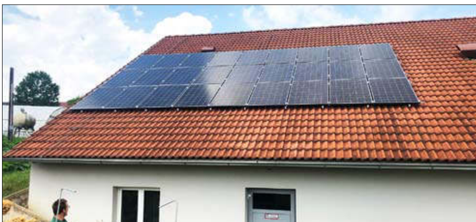
Photovoltaikanlage für das Haus der Musik und den Kindergarten in Bierbaum am Auersbach
