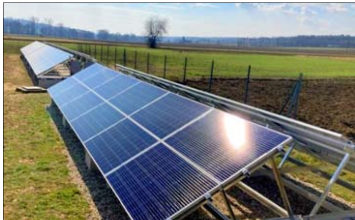
Neu installierte Photovoltaikanlage bei der hiesigen Kläranlage
