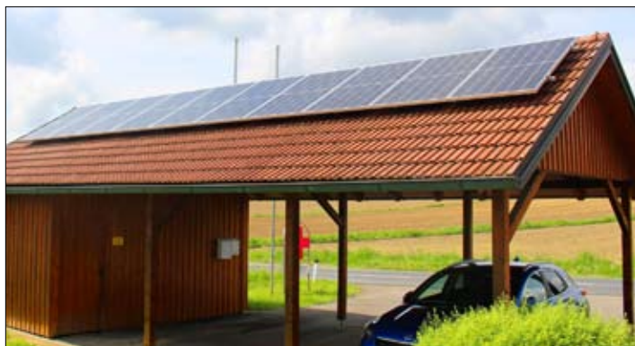
Eine Photovoltaikanlage mit Speicher sorgt für grünen Strom
