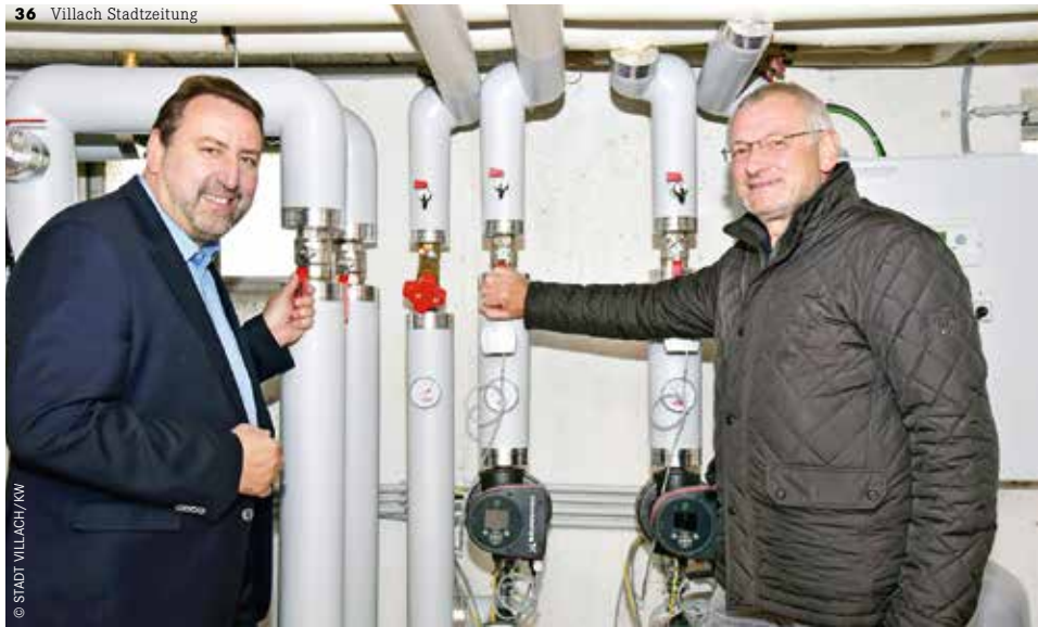
Umweltreferent Stadtrat Erwin Baumann mit Günter Spazier, dem Abteilungsleiter für Wohnungen, vor einer neuen Fernwärme-Übergabestation in Landskron. Auch hier wird aktiv Umweltschutz betrieben.
