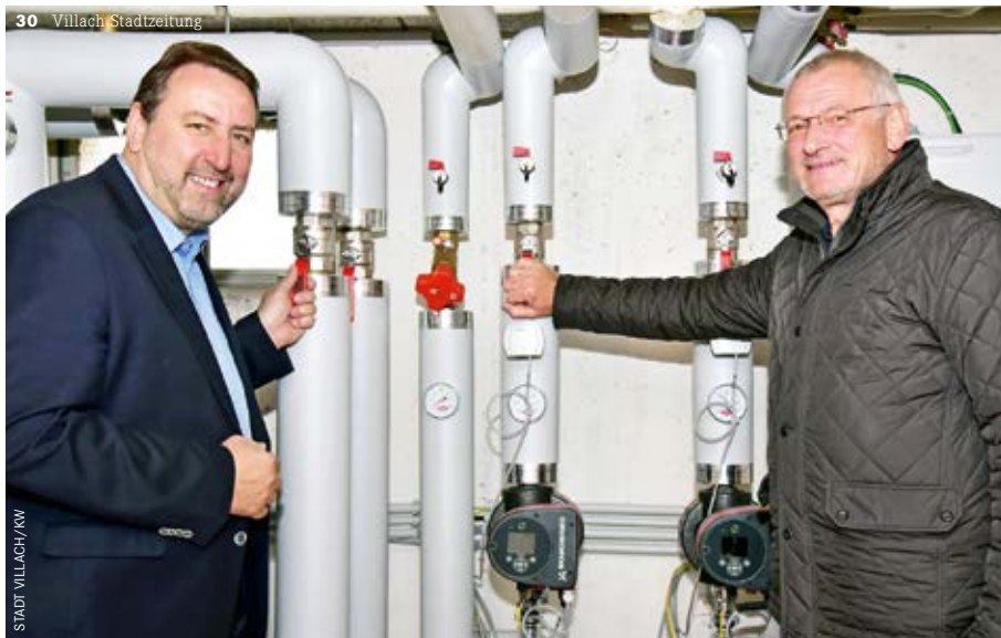
Stadtrat Erwin Baumann machte sich mit Günter Spazier, dem Abteilungsleiter für Wohnungen, ein Bild über die Fernwärme-Übergabestation in Landskron.
