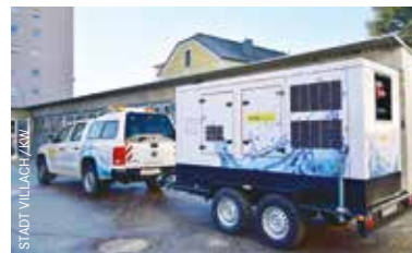
Blick auf das neue Notstromaggregat.
