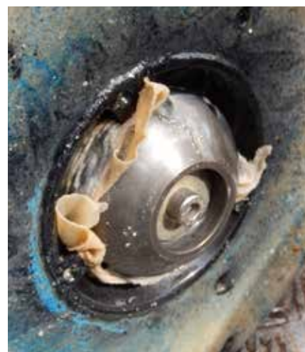
Hier geht nichts mehr: Feuchttücher haben die Pumpe lahm gelegt.
