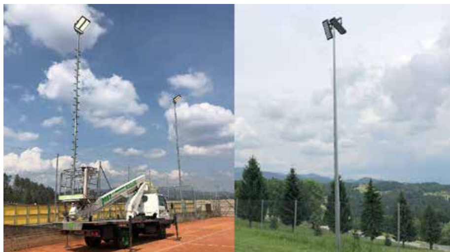
Sowohl unsere Tennisplätze als auch unser Sportplatz wurden mit neuen LED-Strahlern ausgestattet. Vom Land Steiermark gibt es dafür eine großzügige Förderung.
