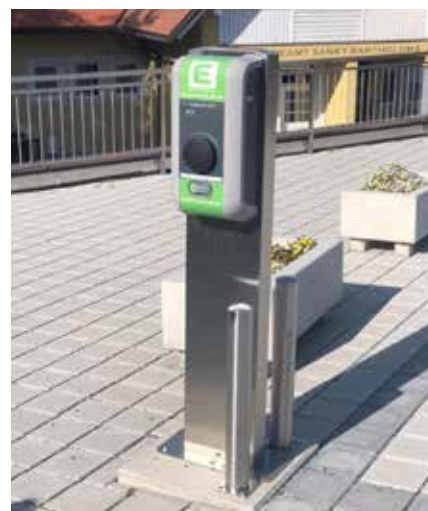
Die E-Tankstelle oberhalb des Gemeindeamtes ist in Betrieb und Online.
