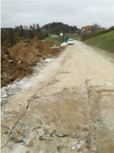
Eine dauerhafte Lösung des abgebildeten Problems ist in Arbeit.
