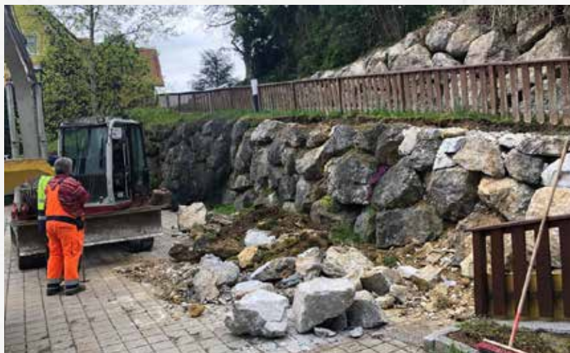
Die Steinmauer zwischen dem Gemeindeamt und dem Bartholomäer Kirchenwirt ist brüchig geworden.
