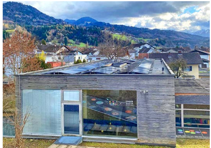
Die vierte PV-Anlage auf gemeindeeigenen Gebäuden wurde beim Kindergarten installiert.
