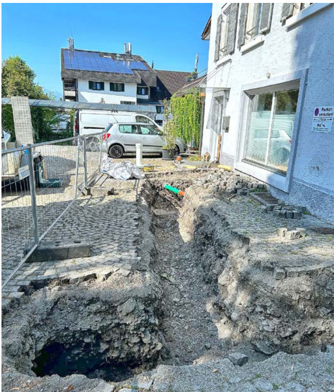
Nahwärmeanschluss für das alte Schulhaus in der Hummelbergstraße 25
